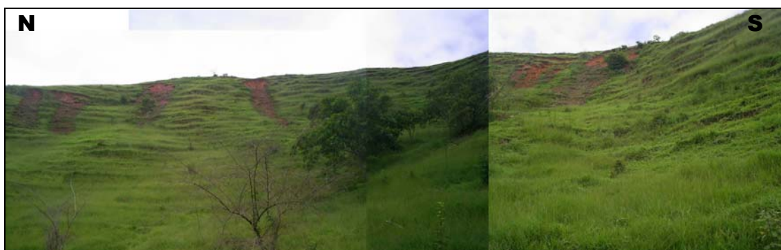
Foto 6 – Diversos pequenos escorregamentos com presença de lixo. Notar degraus ao longo da topografia sugerindo processo de rastejo, ou seja, movimentação constante de velocidade muito baixa a baixa (cms/ano) e decrescentes c/ a profundidade
