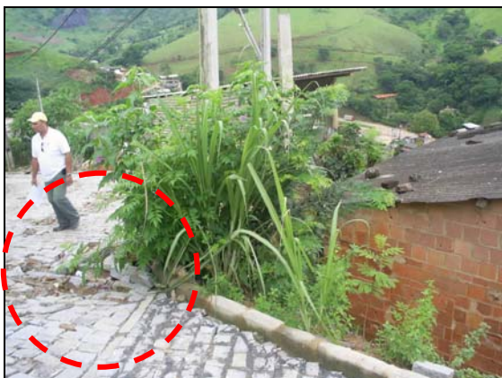
Foto 7 – Paralelos soltos pelo fluxo das águas. Necessidade de maior compactação.
