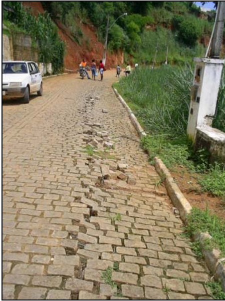
Foto 15 – Trinca em acesso de Euclidelândia.
