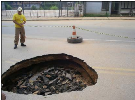
Foto 9 – Rodovia RJ 160 parcialmente interrompida em consequência de colapso da pista de rolamento. Águas oriundas de quebra de manilha carregaram material da fundação, afetando também posto de saúde ao fundo.
