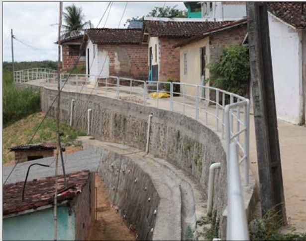
Foto: Prefeitura de Jaboatão dos Guararapes/PE. Acesso em região íngreme com contenções e drenagem.
