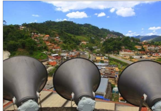
Foto: Rogério Santana / Governo do Rio de Janeiro Sistema de alerta para riscos geológicos em Niterói/RJ.
