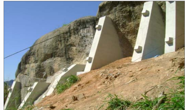
Créditos : Defesa Civil do Espírito Santo Uso de contraforte
