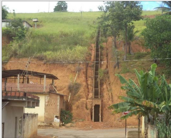
Créditos: Natália Lopes – CPRM/SGB Escada hidráulica com erosão lateral Local: Iapu - MG
